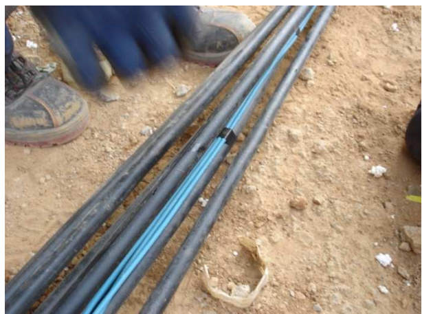
Figura 7: Montaje de los cables de conexión entre los sensores y el equipo de control
