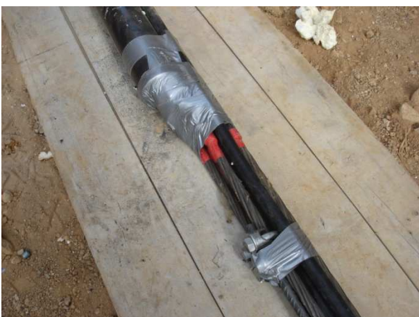
Figura 6: Sensor instalado en la zona libre de un anclaje
