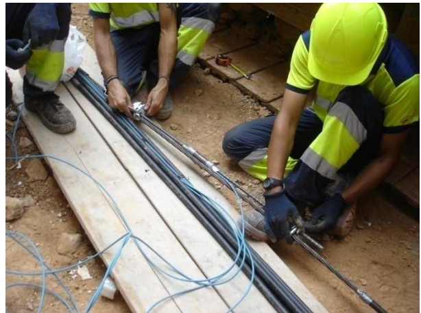
Figura 3: Montaje de sensores en un anclaje
