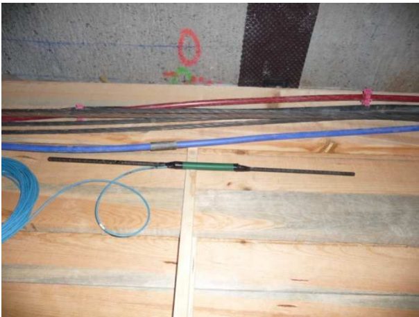
Figura 2: Sensor de deformaciones con su barra de soporte
