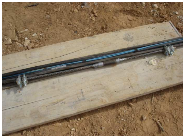
Figura 5: Sensor instalado en el bulbo de un anclaje (fijado al cordón)
