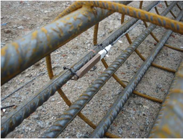
Figura 1: Fijación de un sensor a la armadura del pilote
