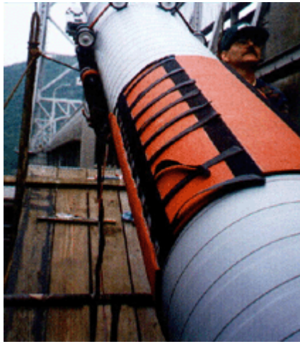
Manta eléctrica de calentamiento instalada sobre un tirante encintado
